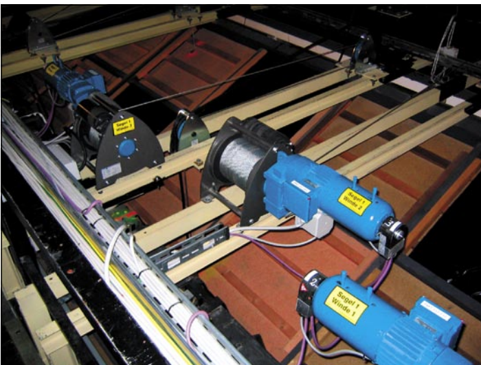
Elektrischer Antrieb der Deckensegel
